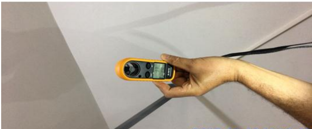
Figura 32 – Medição da velocidade do ar no ventilador 1
