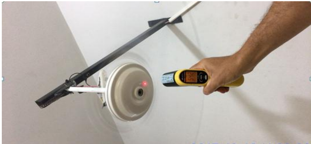
Figura 36 – Medição de temperatura ventilador 1
