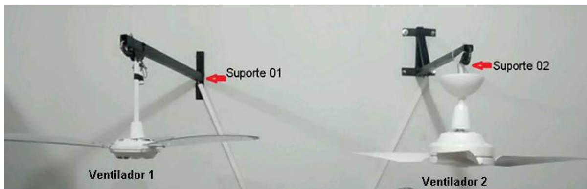
Figura 25 – Estrutura de sustentação dos ventiladores
